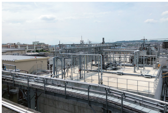
排水処理設備外観
